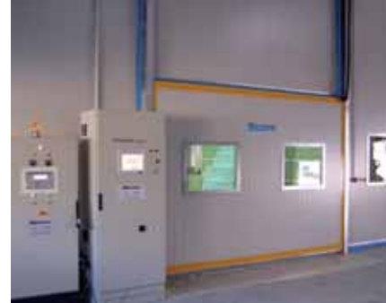
Main control cabinets Armoires générales de contrôle
