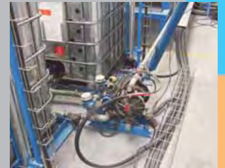
Automatic transfer of resin from supplier drum into buffer drum Transfert automatique de la résine du container fournisseur vers le fût tampon
